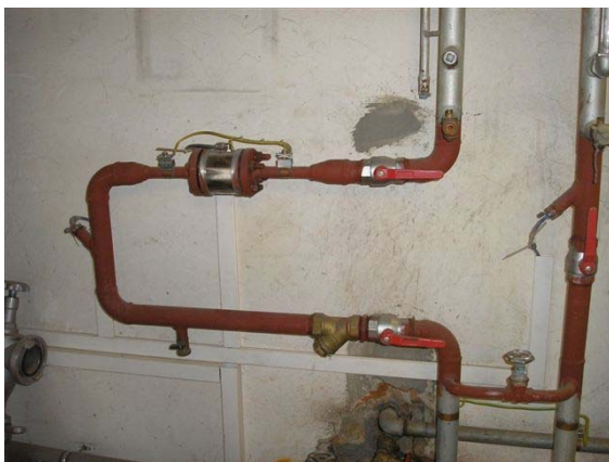
Foto I Potrubí pro dodávky tepla není izolováno.
