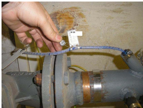
Foto O Izolace není na celém potrubí, ani na deskovém výměníku.
