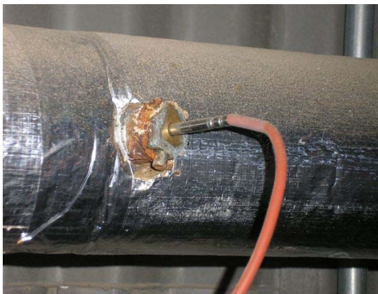
Foto G Teploměry nejsou plně zasunuty do jímek.
